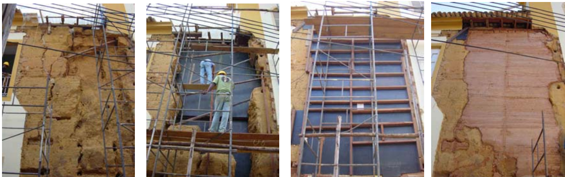
Figura 1 - Sequência fotográfica dos trabalhos de restauro na fachada lateral leste entre janeiro e fevereiro de 2006: a) situação da área com o grande desprendimento e fissuras estruturais; b) desmontagem da área da taipa de pilão comprometida estruturalmente; c) situação após a reconstrução da área, com o "taipal" progressivo; d) após retirada do taipal, vista da área reconstruída
